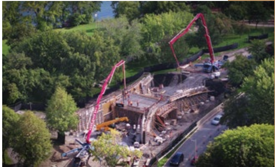
► Vue aérienne d'un des ponts Darwin en septembre 2020 Photo : Les Services EXP
